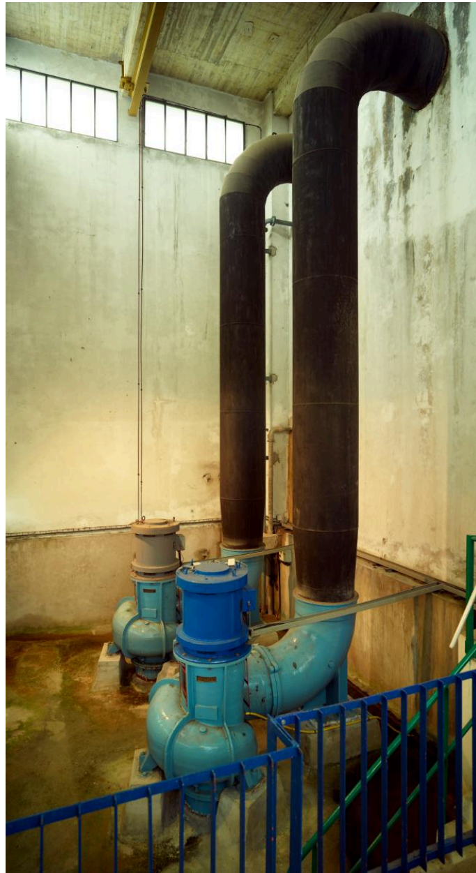
Pompes à l'intérieur de la station de pompage.
