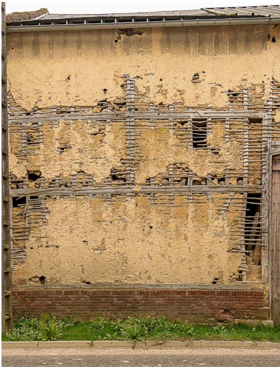
Détail de la mise en oeuvre en torchis et pans de bois de la grange n°10 Grande Rue.
