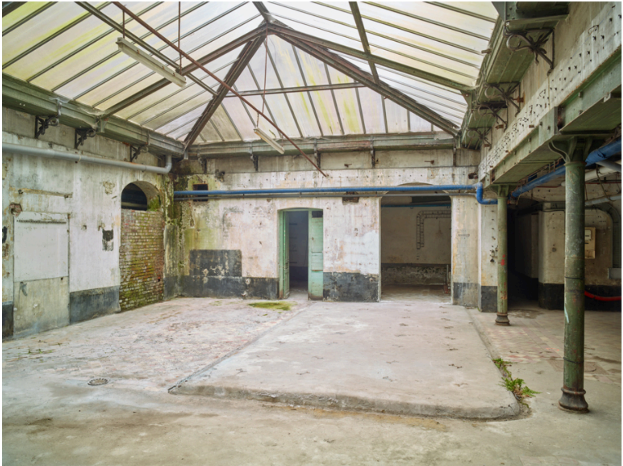
Aile sud, sous-sol. Vue générale de la cour vitrée de la lingerie vers le nord.
