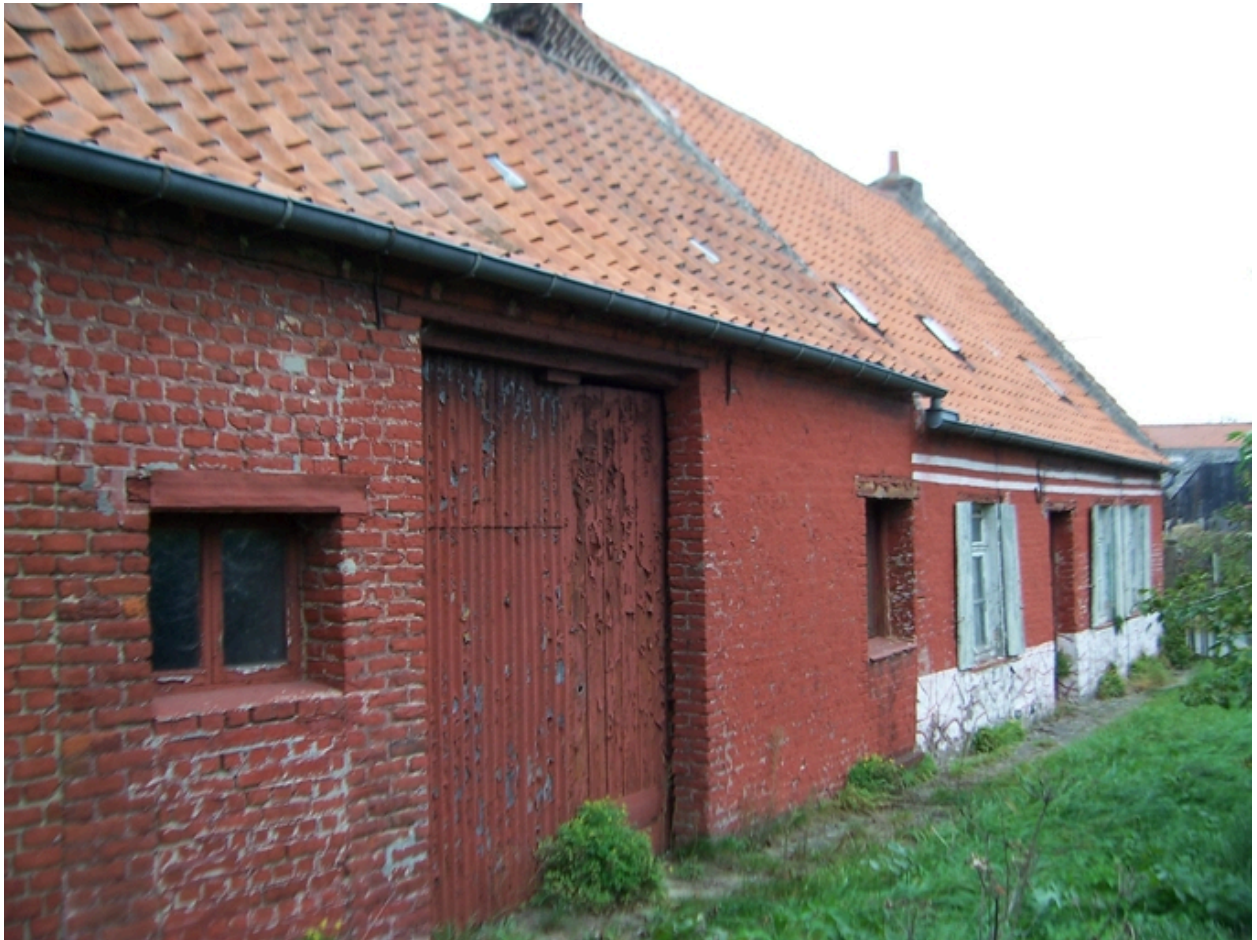
Vue de trois quarts de la façade de l'étable et de la grangette.
