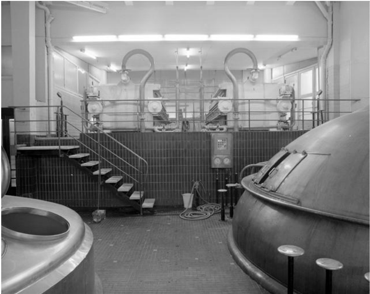
Salle de brassage ; au fond, filtre à moût.
