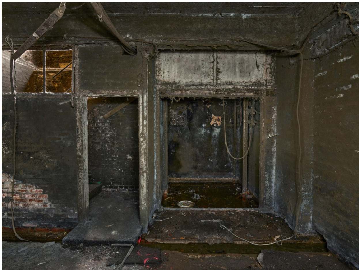
Bâtiment A, monte-charge depuis le sous-sol.
