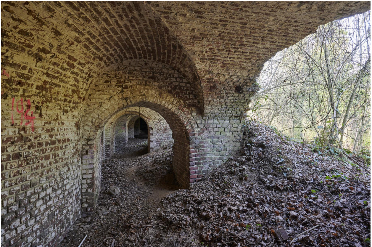
Aile est. Partie effondrée des galeries flanquantes.
