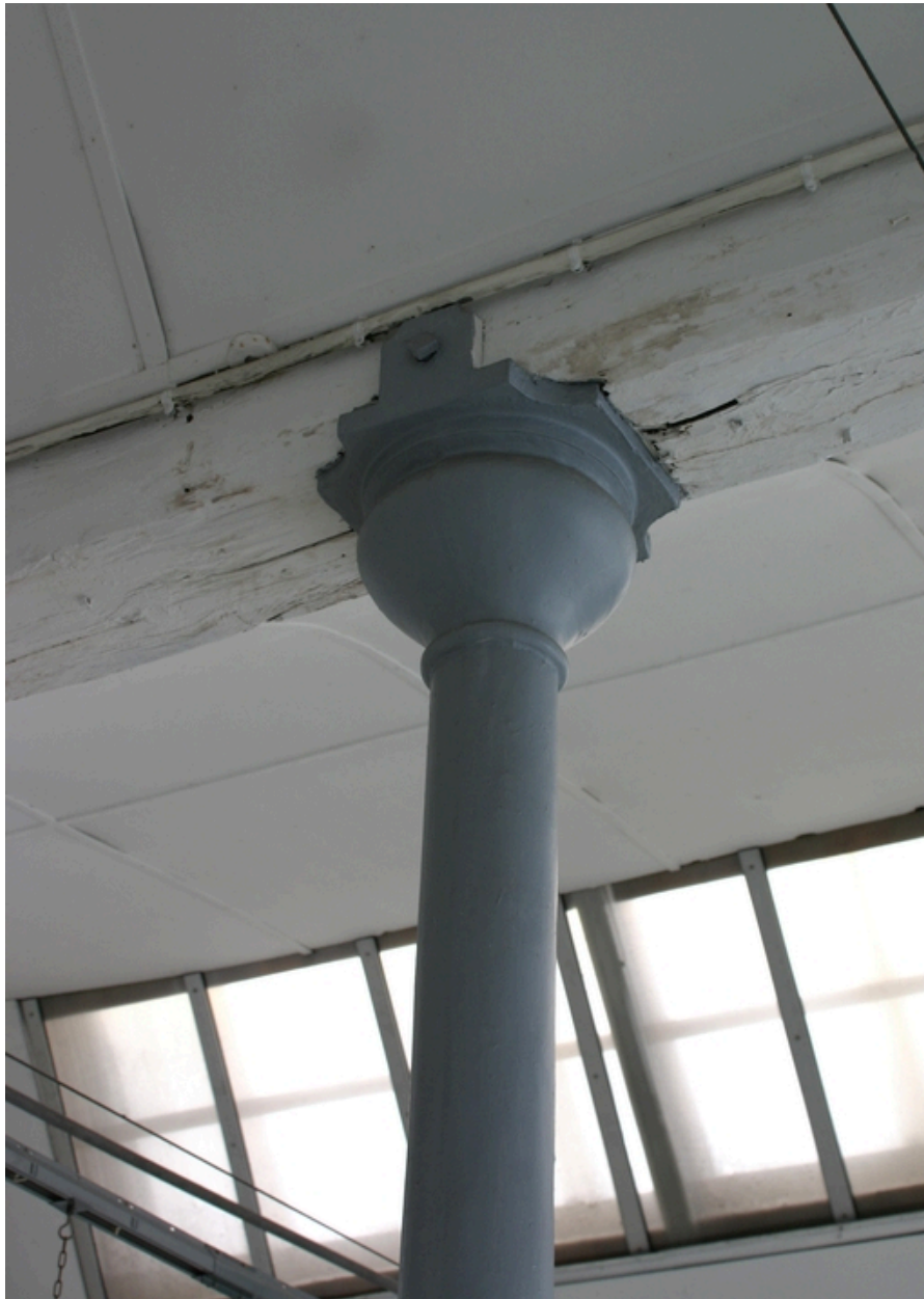
Ateliers antérieurs à 1900 (ensemble ouest) : chapiteau d'une colonne en fonte de l'étage.
