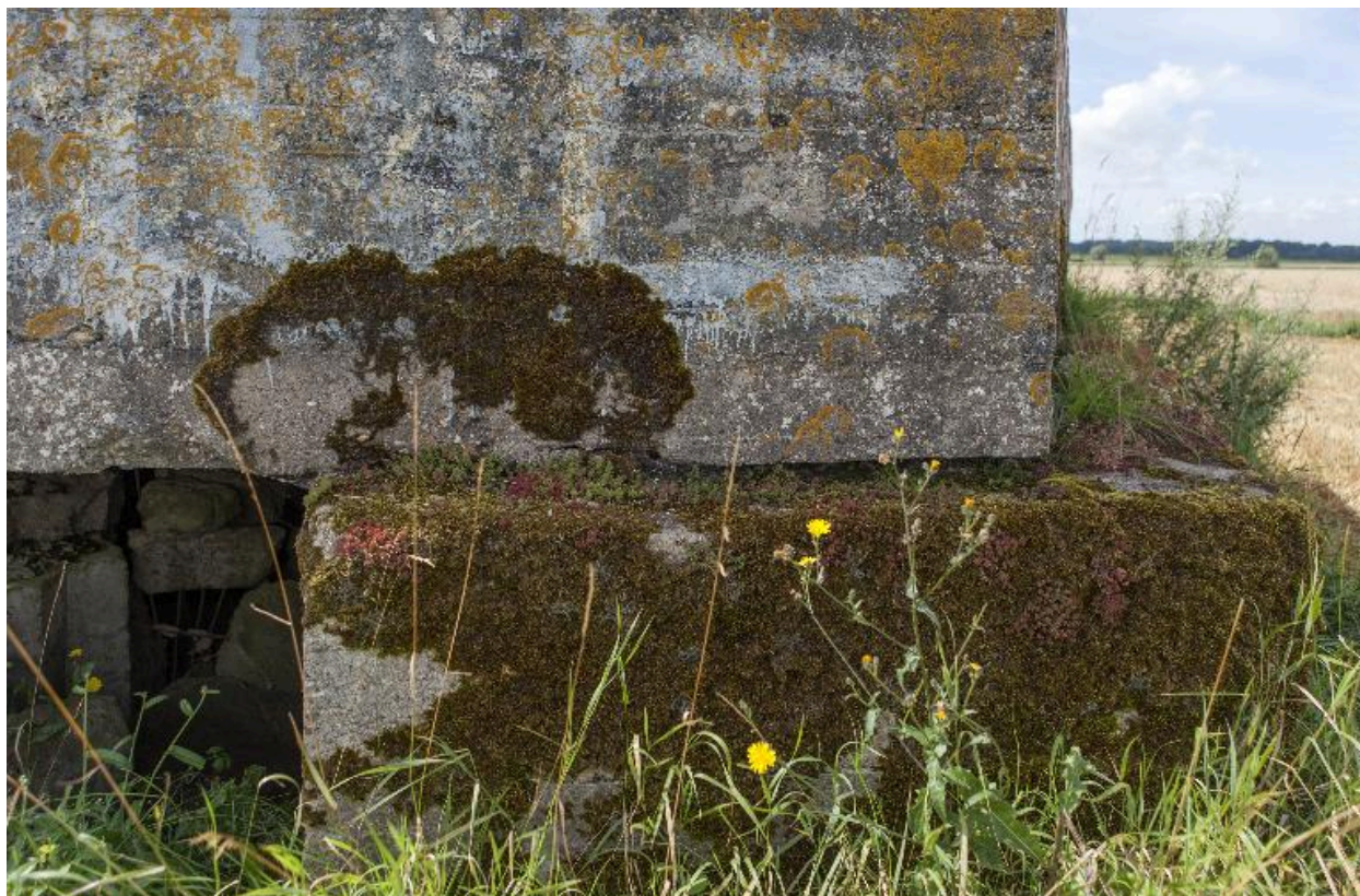
Angle nord-est. Effet du dynamitage de l'abris
