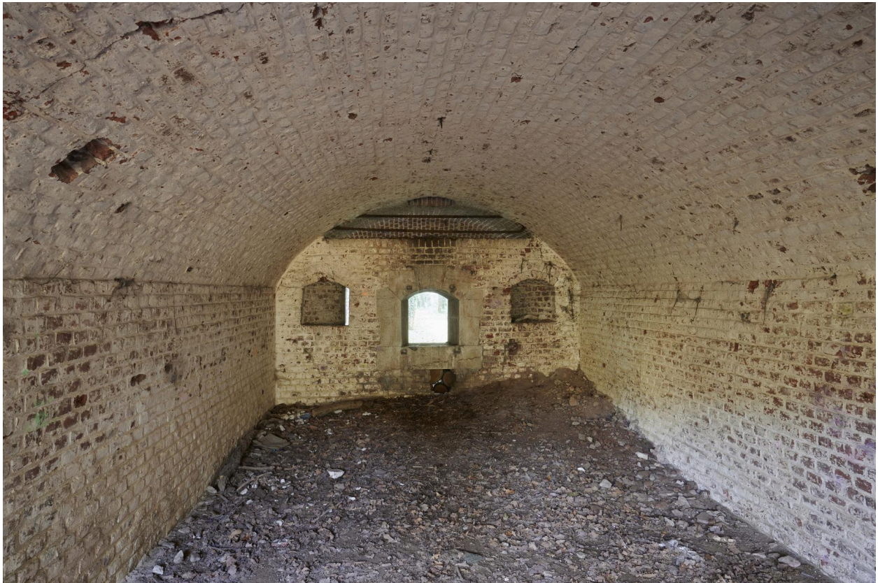
Aile est. Chambre de tir de la caponnière double et cheminée d'évacuation des fumées.
