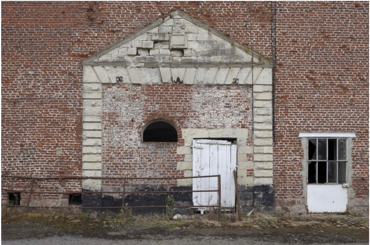
Vue du fronton et des pilastres sur la façade de la grange-étable.
