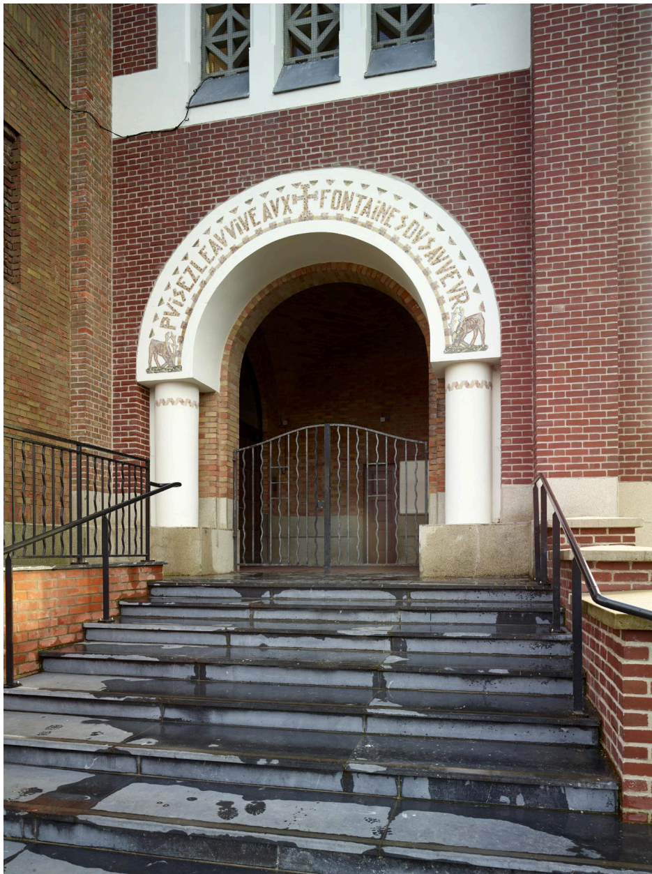
Vue de détail de l'arc du premier niveau du clocher-porche côté nord.
