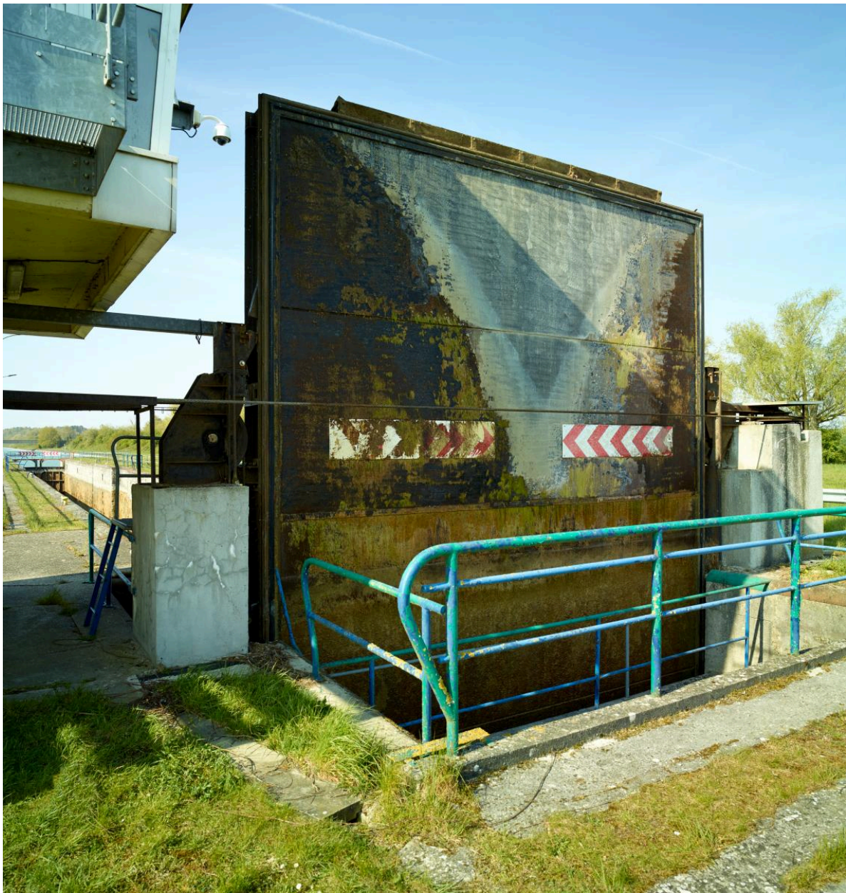
Porte levante en aval du site.
