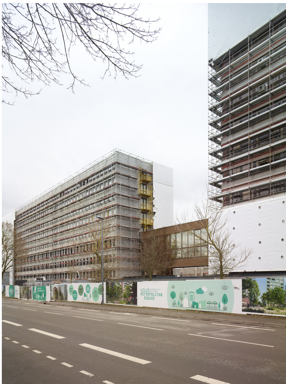
Vue générale vers le sud, depuis la rue du Ballon, en cours de démolition.
