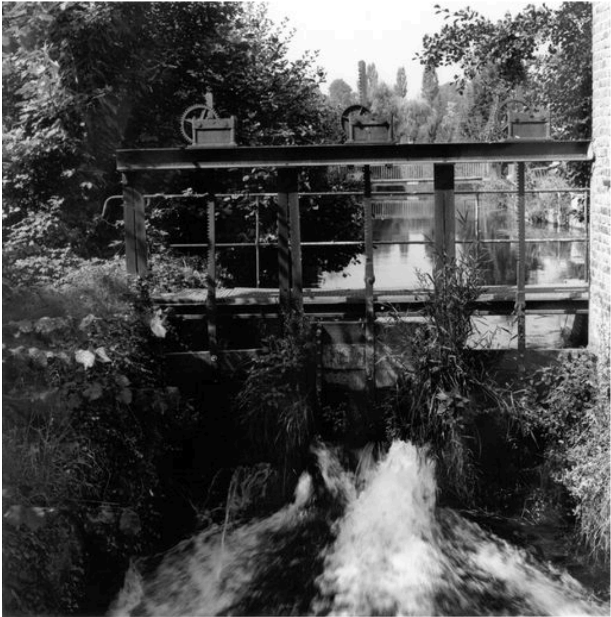
Le vannage de décharge.
