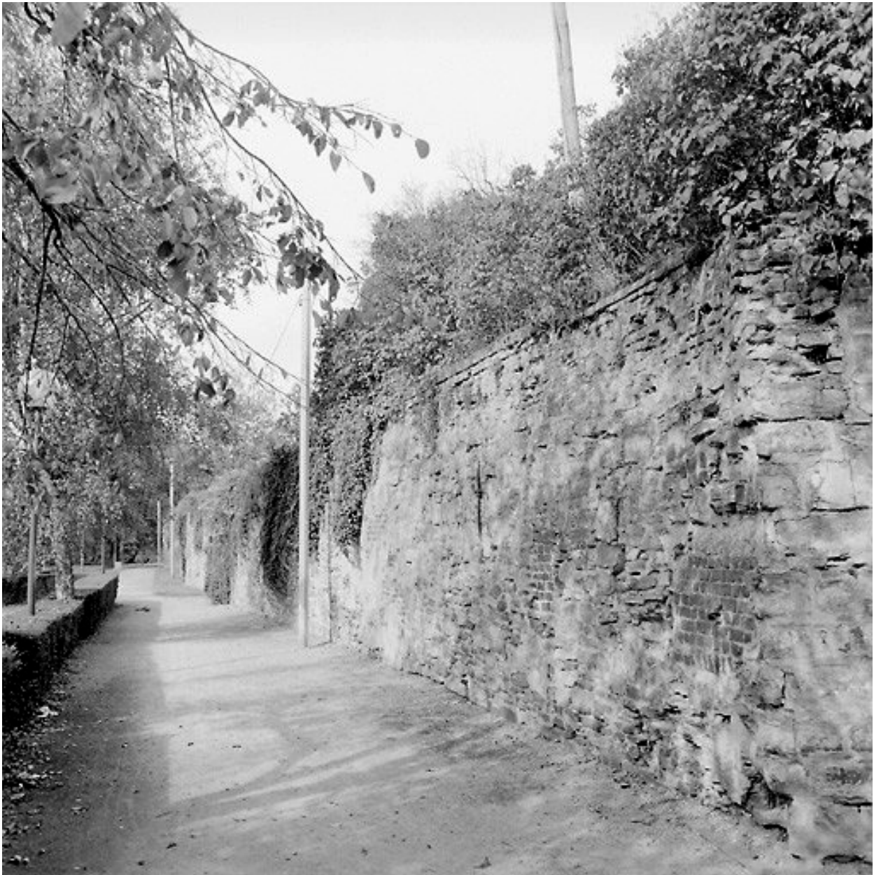
Front sud (square de l'Escaut) : vue générale de la courtine depuis le sud-est.
