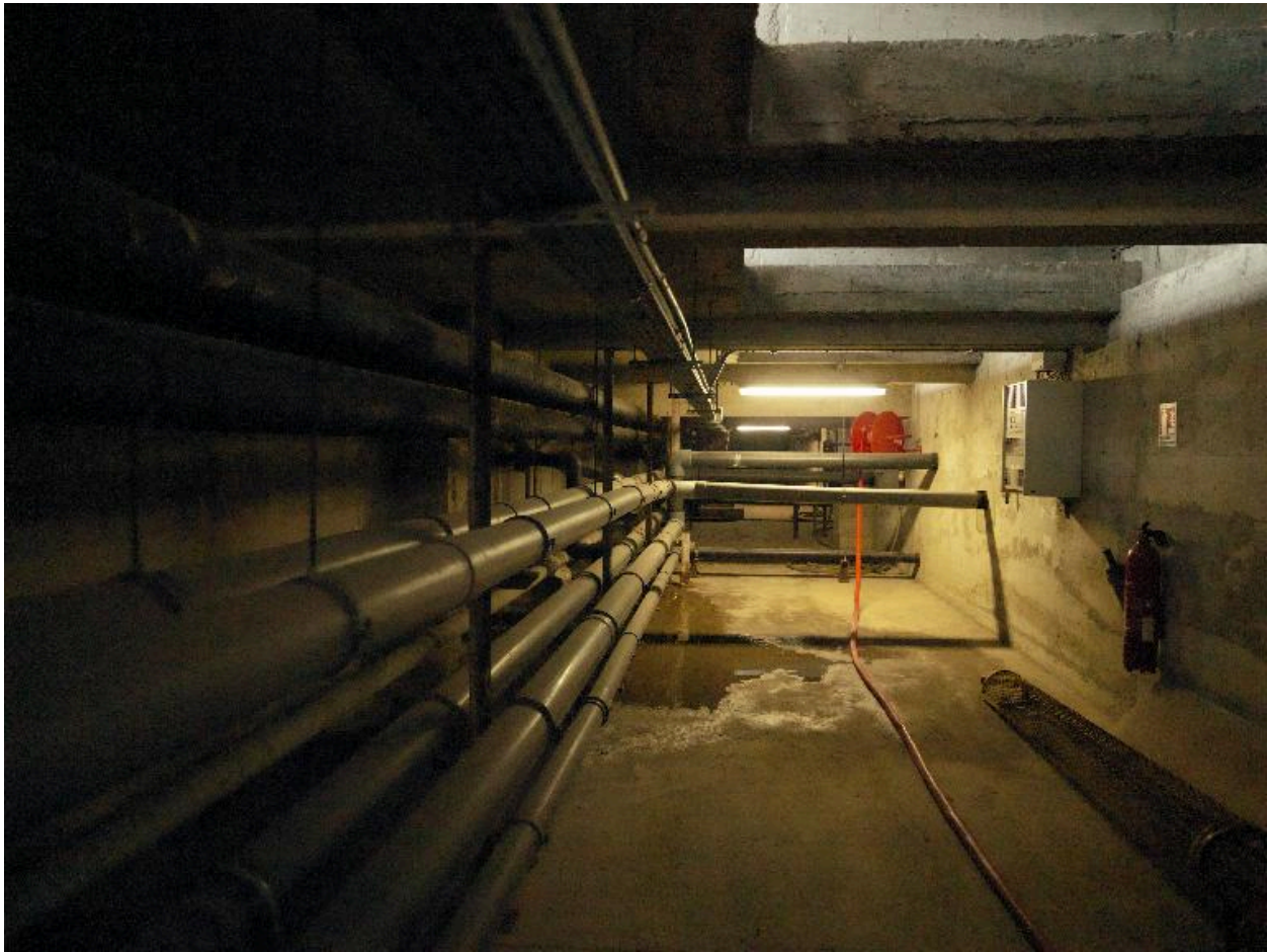
Galerie technique (tuyauterie) sous le bassin.
