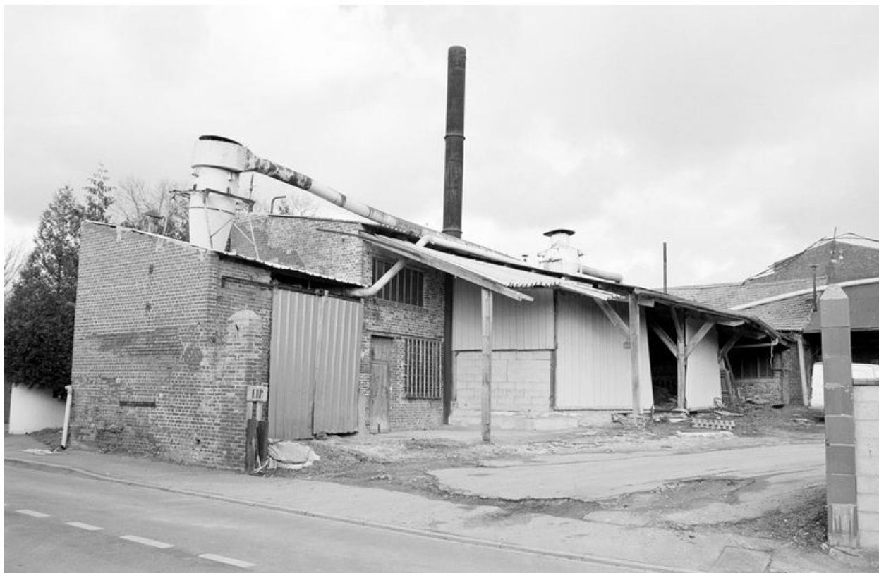
Chaufferie avec sa cheminée métallique.
