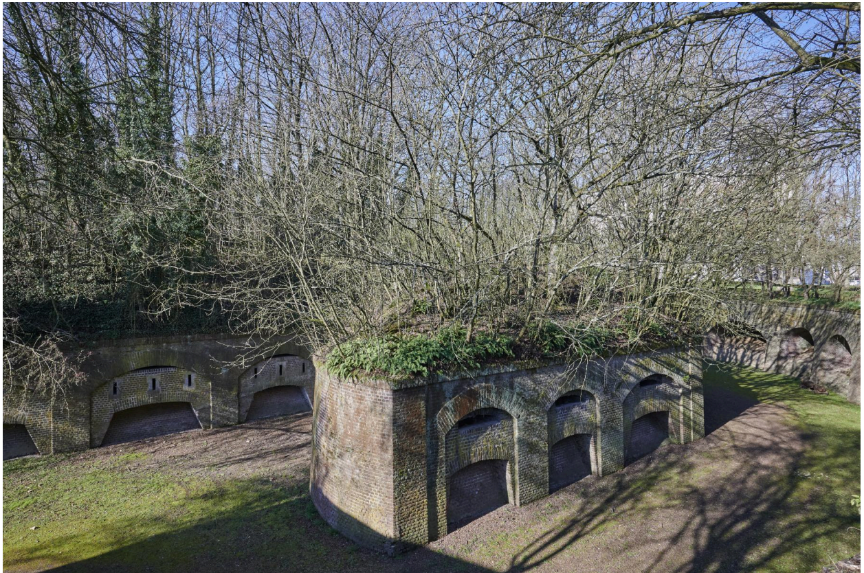
Orillon de la caponnière simple, vue en plongée depuis la contrescarpe, vers le nord.
