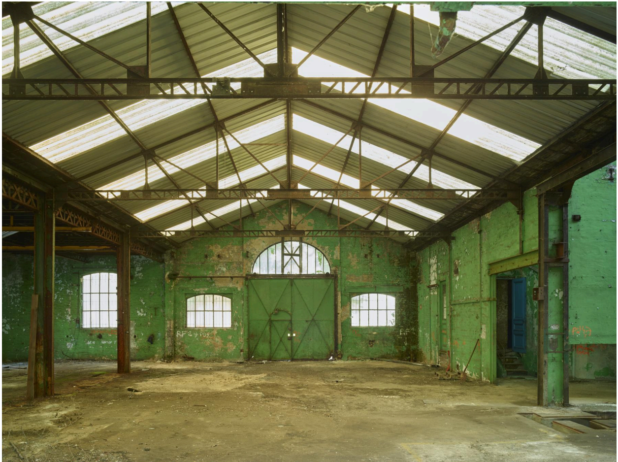
Vue intérieure, vers le nord-est, de l'atelier de fabrication ouvrant place de l'Europe.
