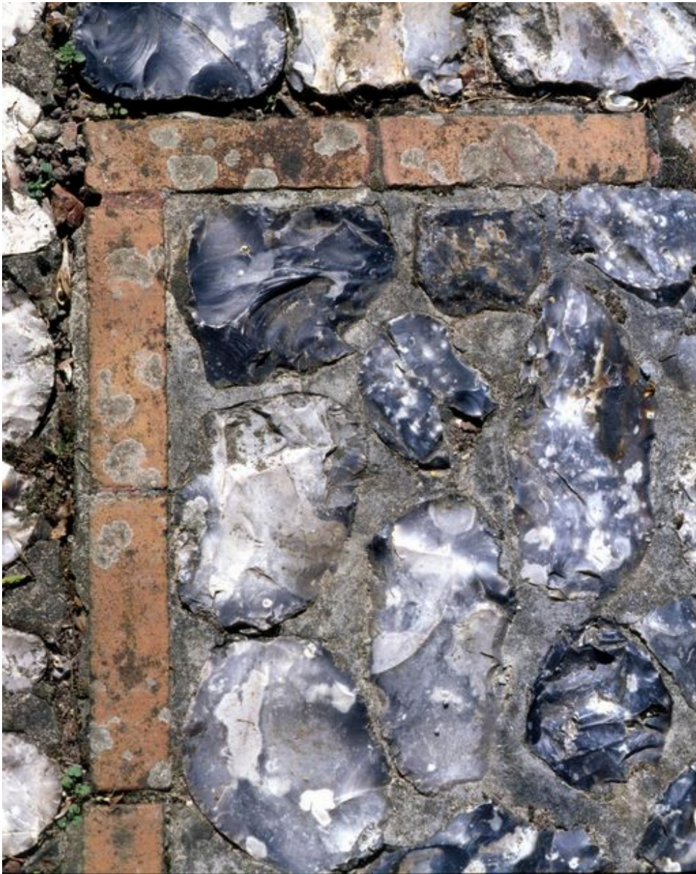
Détail de la mise en oeuvre de l'escalier menant au jardin (rognons de silex).
