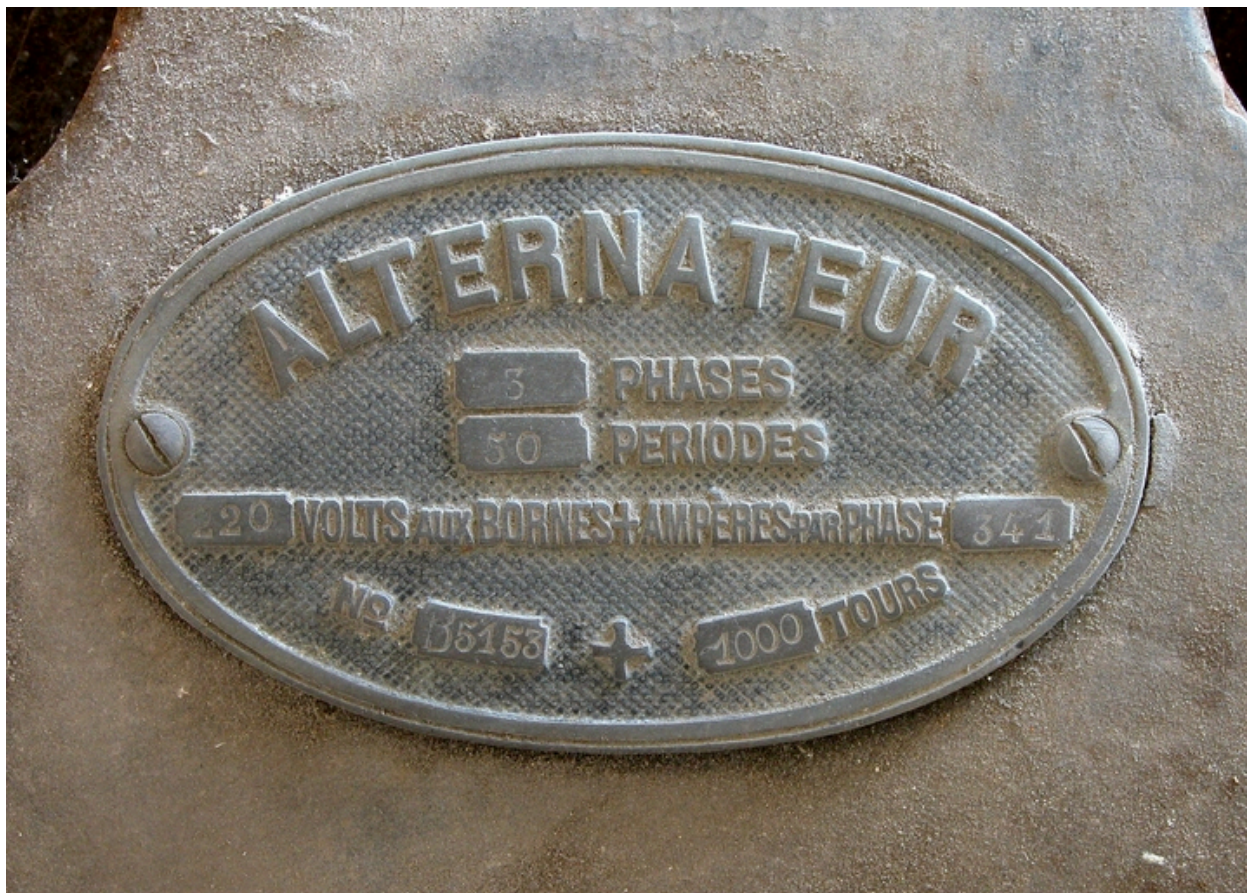
Plaque signalétique de l'alternateur du générateur.
