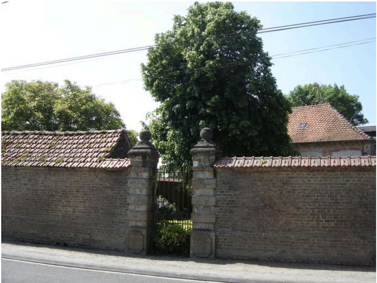
Vue du mur de clôture et de la porte d'accès du n°53.
