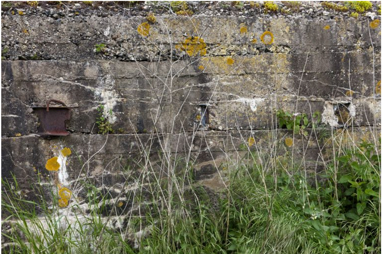
Vue latérale, vers le sud-ouest. Sortie des poutrelles en I soutenant la dalle.
