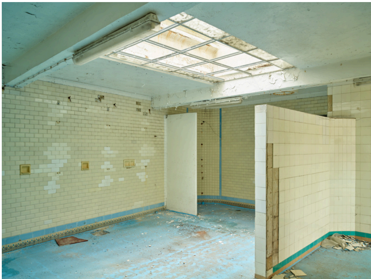
Hydrothérapie du bassin de natation : vue de la salle de douche.
