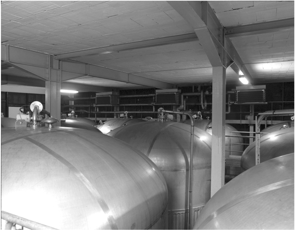
Salle de fermentation, niveau supérieur.
