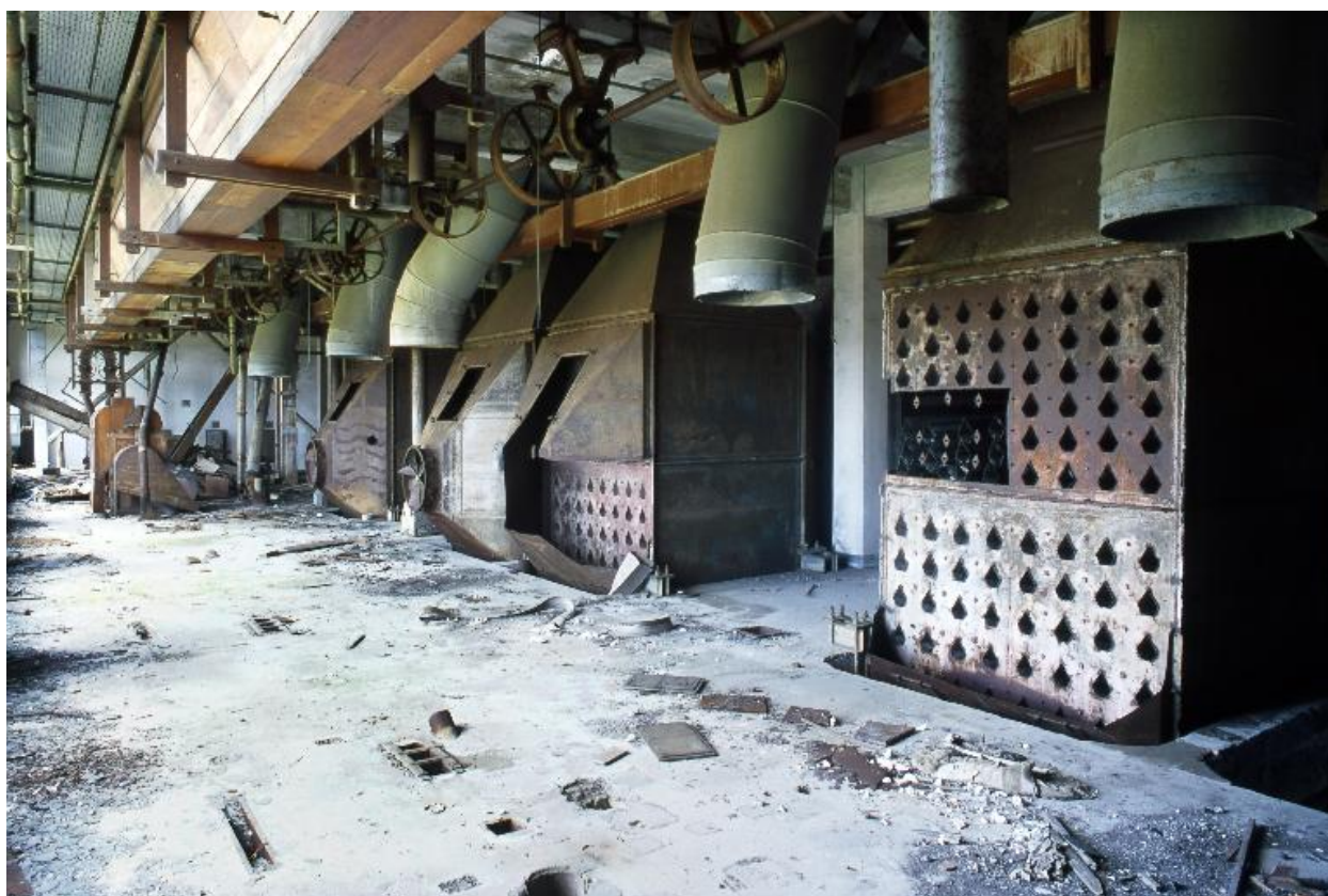
Bâtiment du nettoyage. Trieurs.
