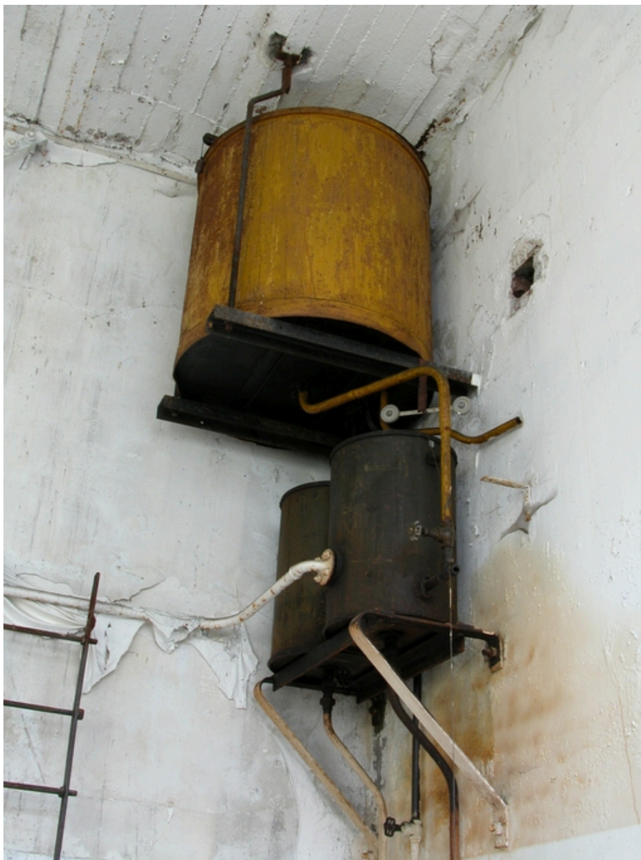
Bacs d'eau pour le refroidissement des cylindres de la machine.
