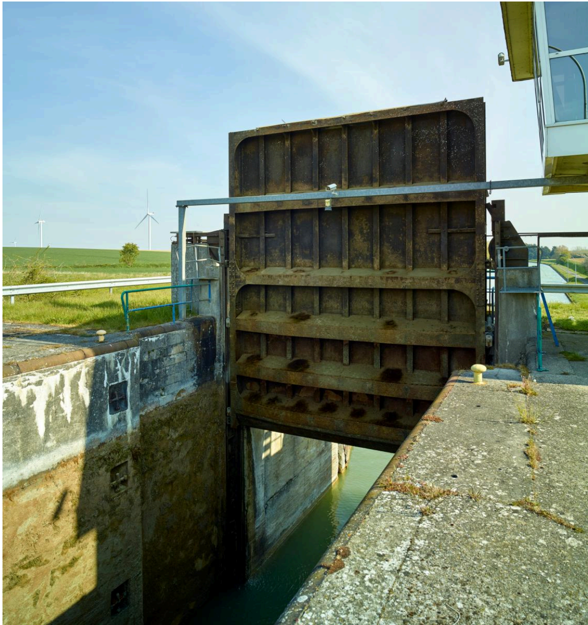
Porte levante en aval du site.
