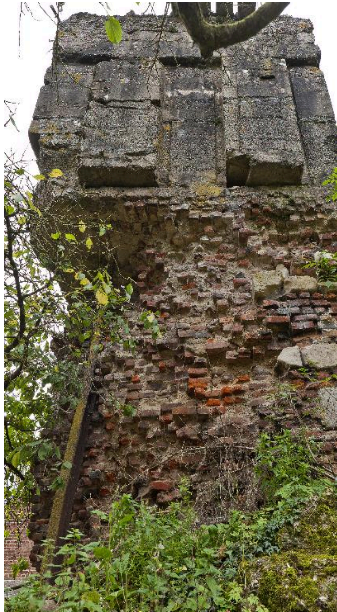
En contre-plongée de l'élévation nord : Détail du sous-bassement en brique et pierre surmonté de la casemate
