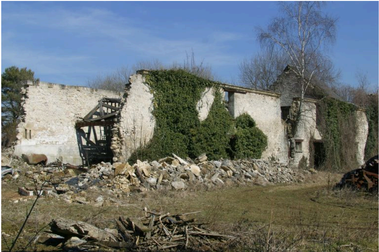
Etat actuel de la grange en ruines.
