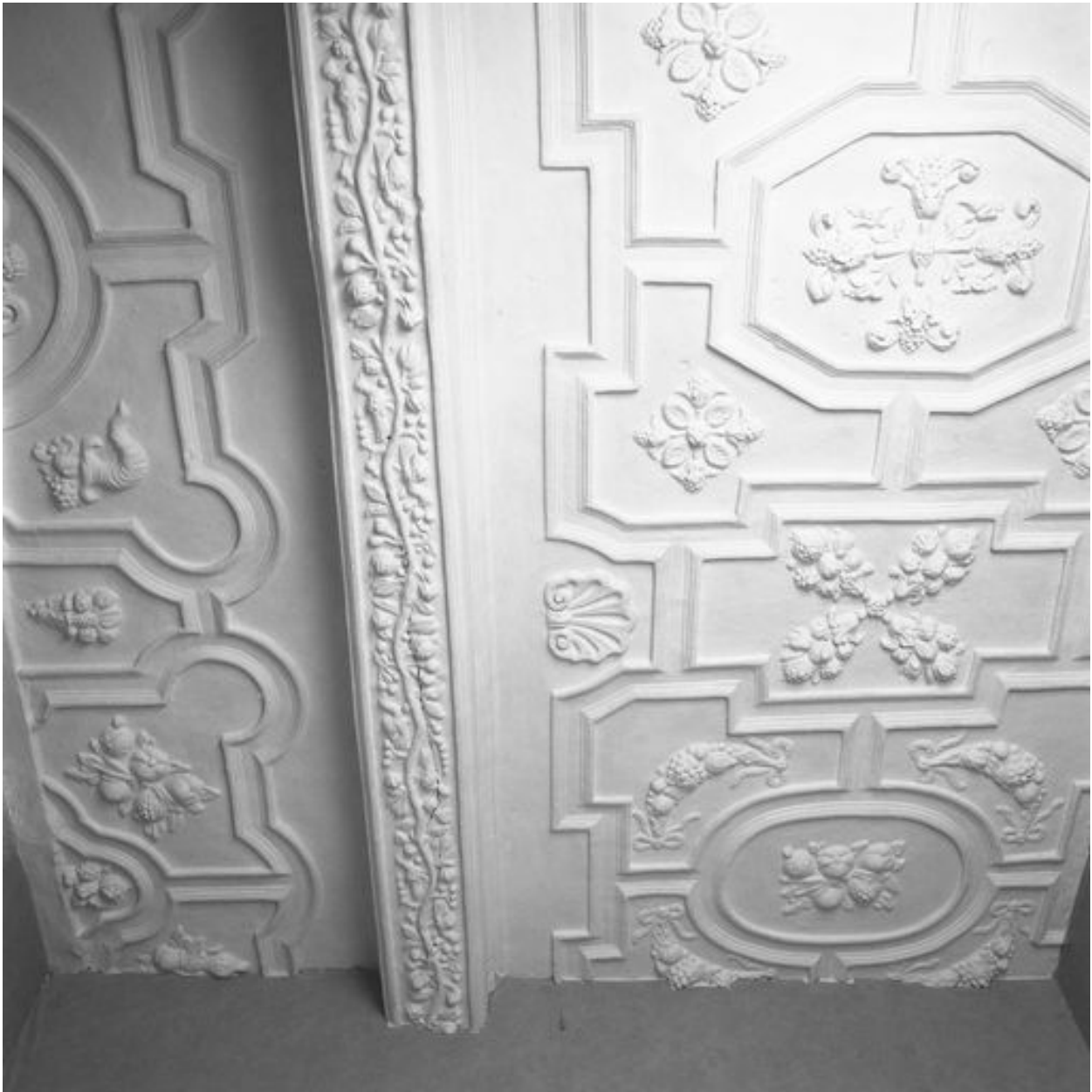
Vue partielle du plafond coupé par le cloisonnement en logements (ici, n° 37 rue de la Cavalerie).
