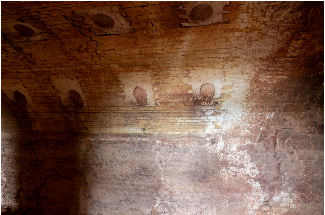
Four Hoffmann. Galerie de cuissons des briques. Vue de détail de briques réfractaires, des événements et des trous d'alimentation en charbon.
