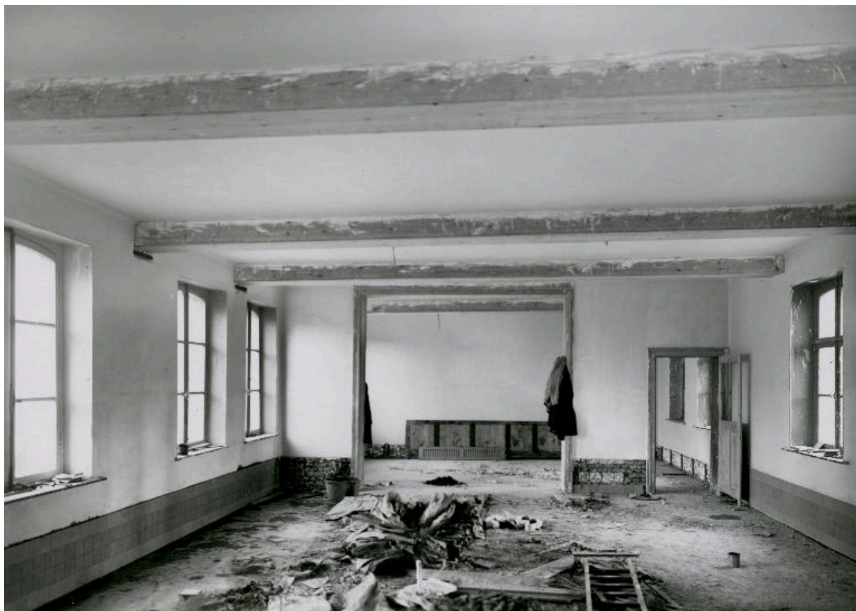
Vue générale de la crèche de l'usine d'Abbeville en cours d'aménagement intérieur, Jean-Pierre Jacquart (photographe), 1937.
