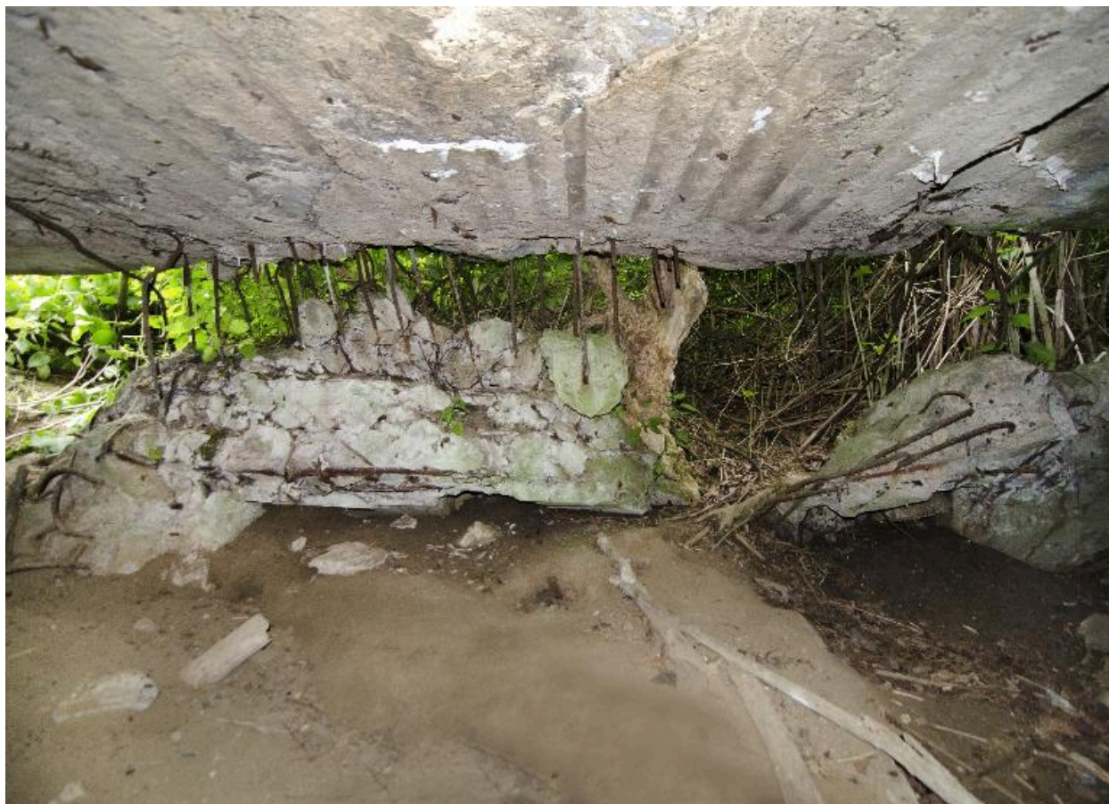
Le mur sud, explosé, de l'intérieur
