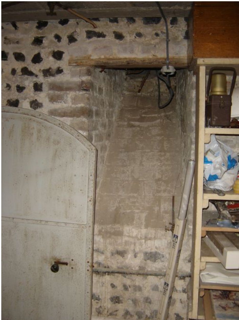
Système d'aération de la cave.
