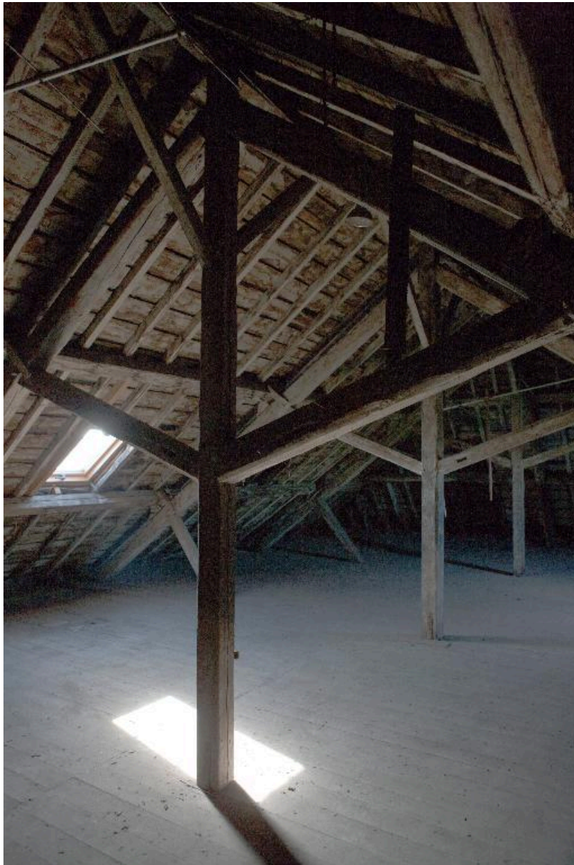
Les combles et la charpente du collège Notre Dame des Anges rue du Bruille.
