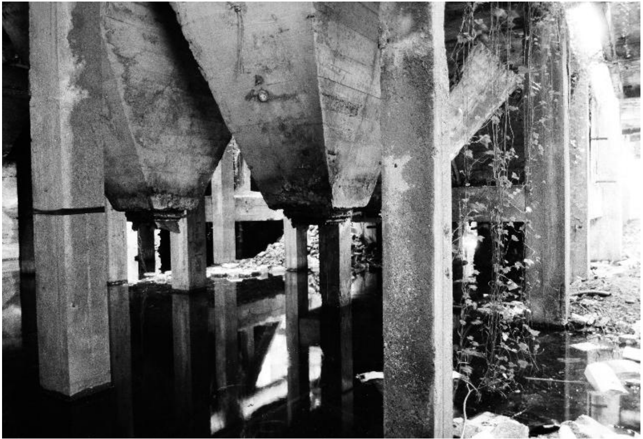
Atelier, salle des goulottes, détail.
