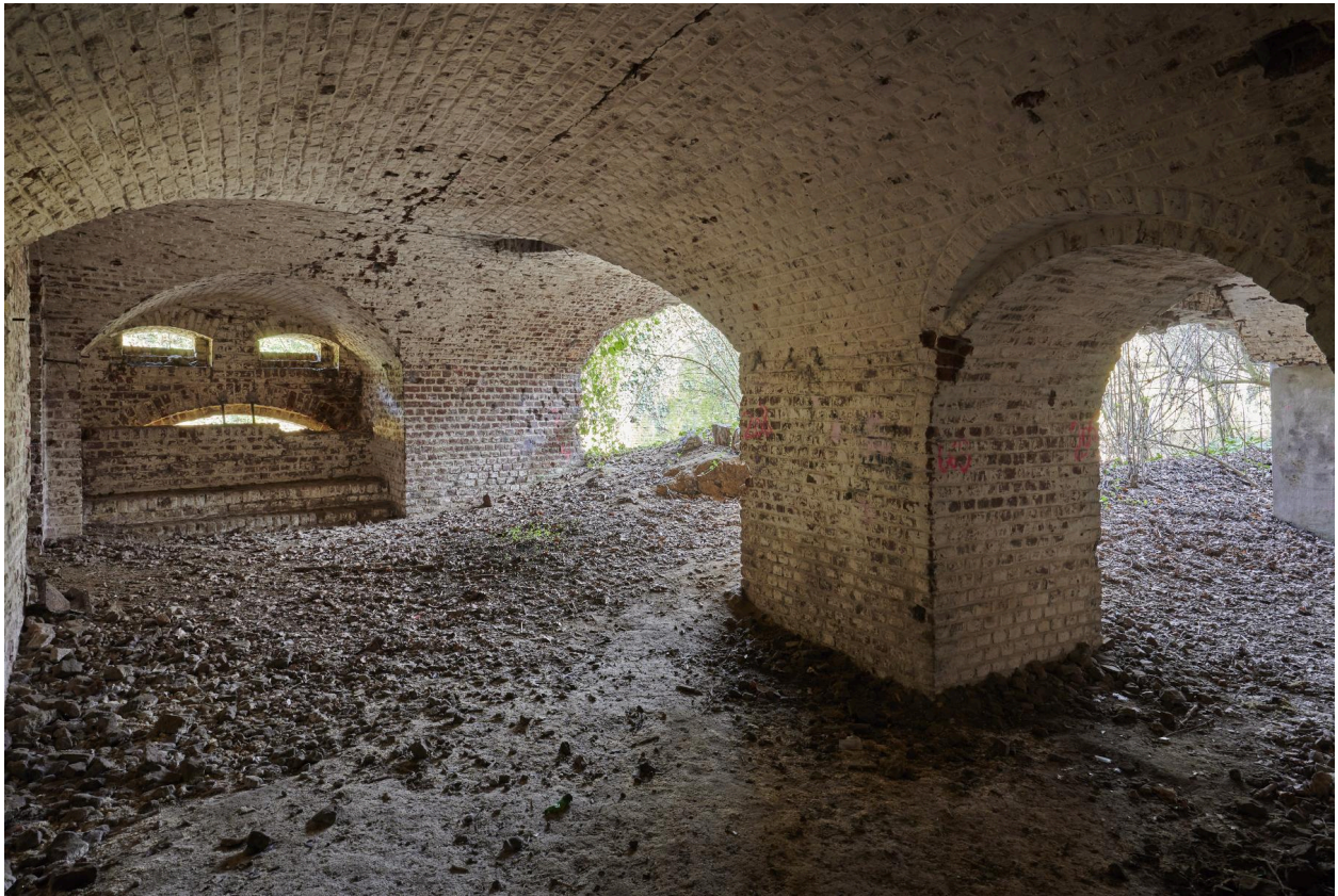
Aile est. Caponnière double. Embrasures de tir dans le mur de la galerie de flanquement, en partie effondrée.
