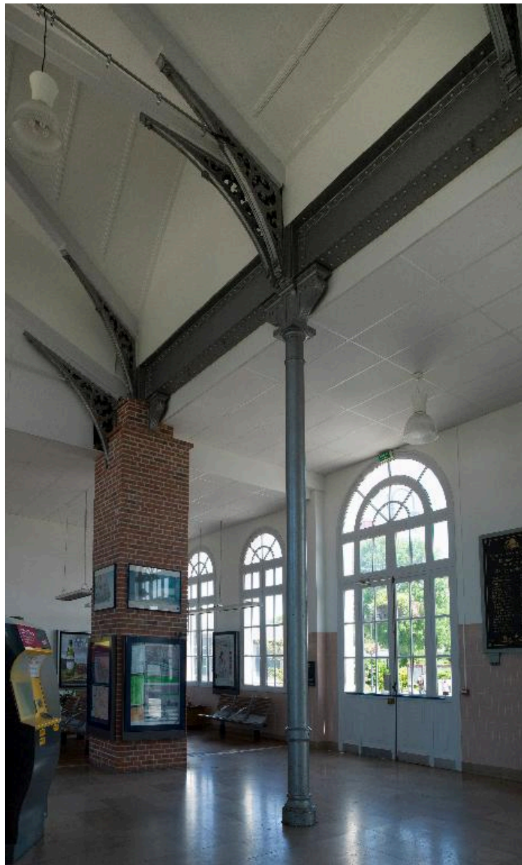
Vue de la poutre IPN soutenue par un poteau en fonte à l'intérieur de la gare.
