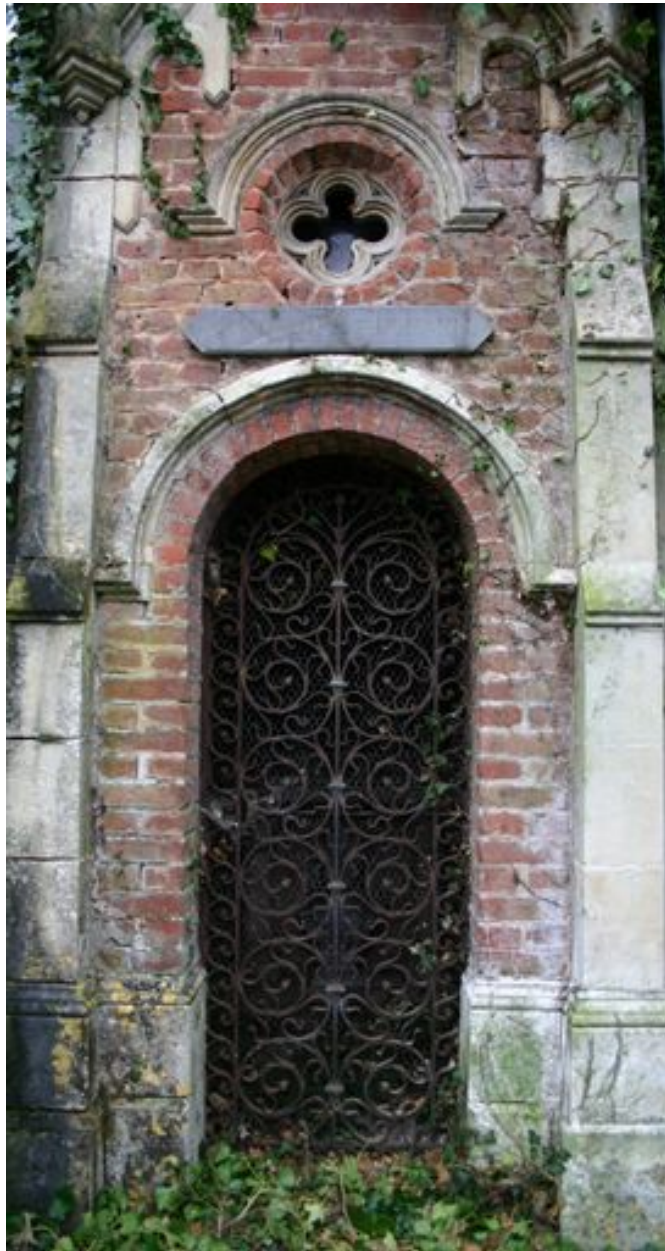
Détail de la façade principale, percée d'une porte cintrée en fonte et fer forgé.
