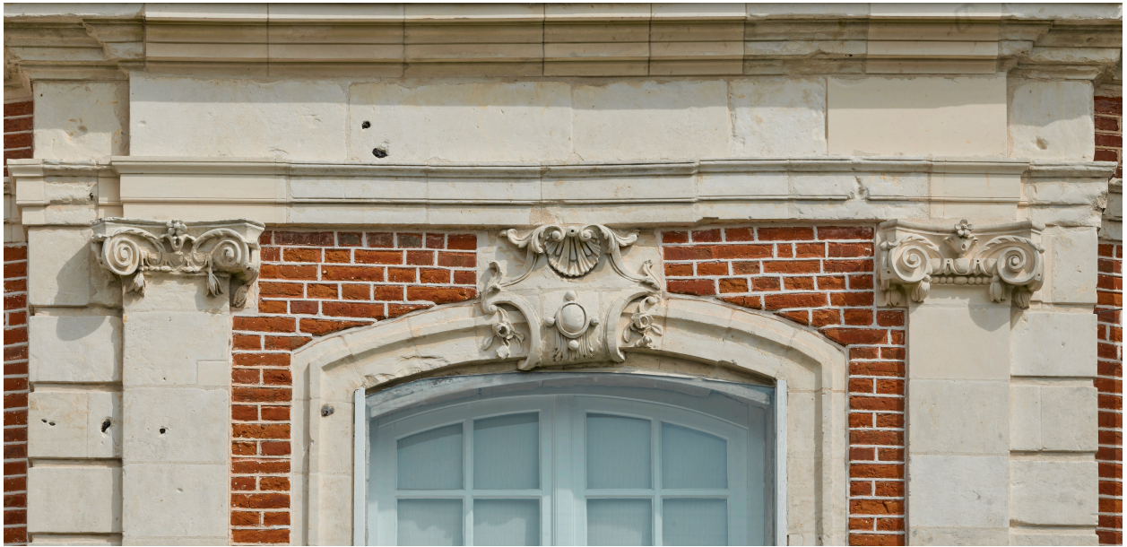
Pavillon sud, façade sur cour, détail des chapiteaux sculptés et de l'agrafe en couronnement de la baie.
