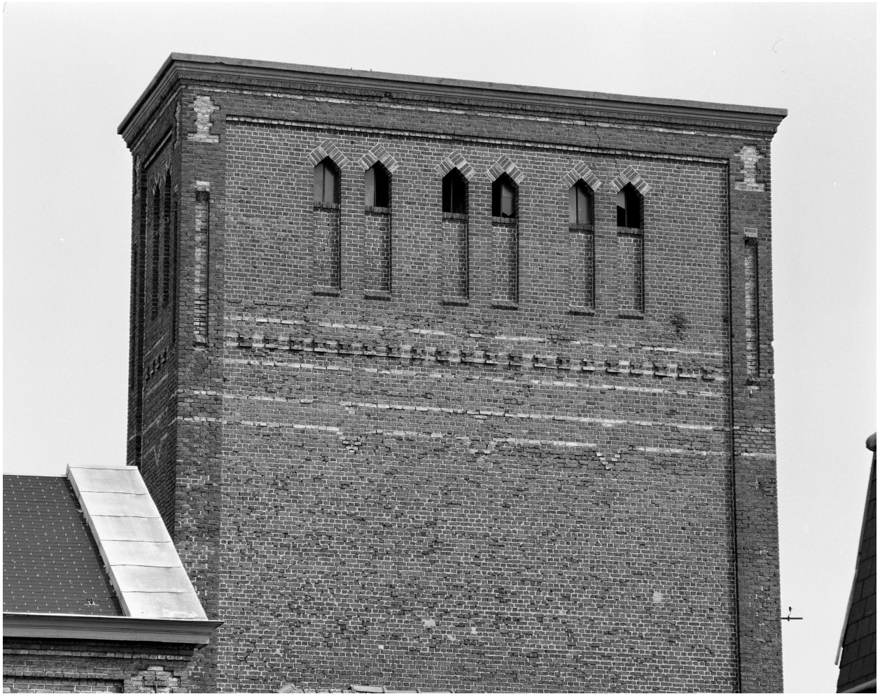
Chaufferie, détail du château d'eau.
