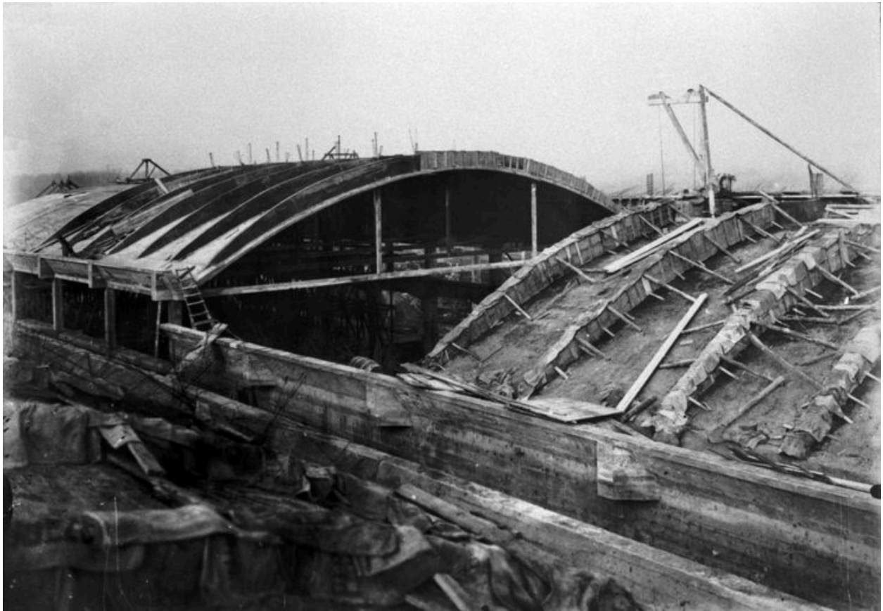
Détail de la construction des voûtes des ateliers en béton armé, vers 1922 (AC Thourotte).
