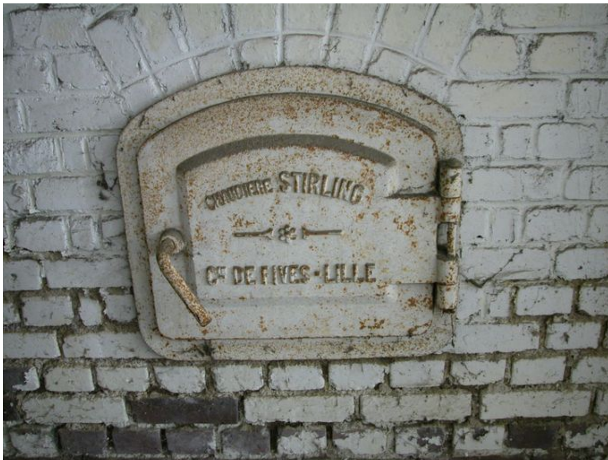
Détail de plaque de chaudière Sterling.
