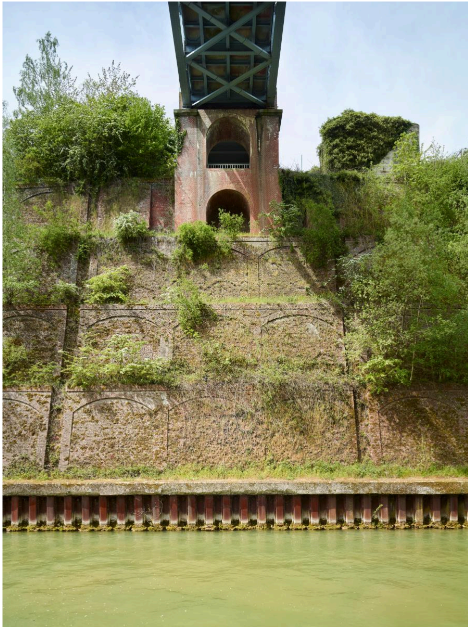
Sou le pont sud (rive ouest). Vue des murs de soutènements en gradins et culée du pont sud.
