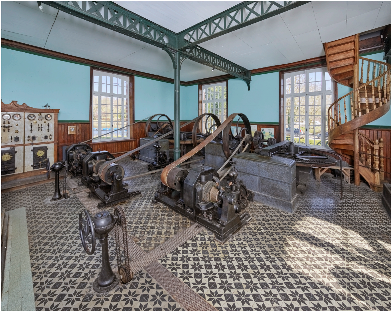
Intérieur, les deux premières turbines de la centrale.
