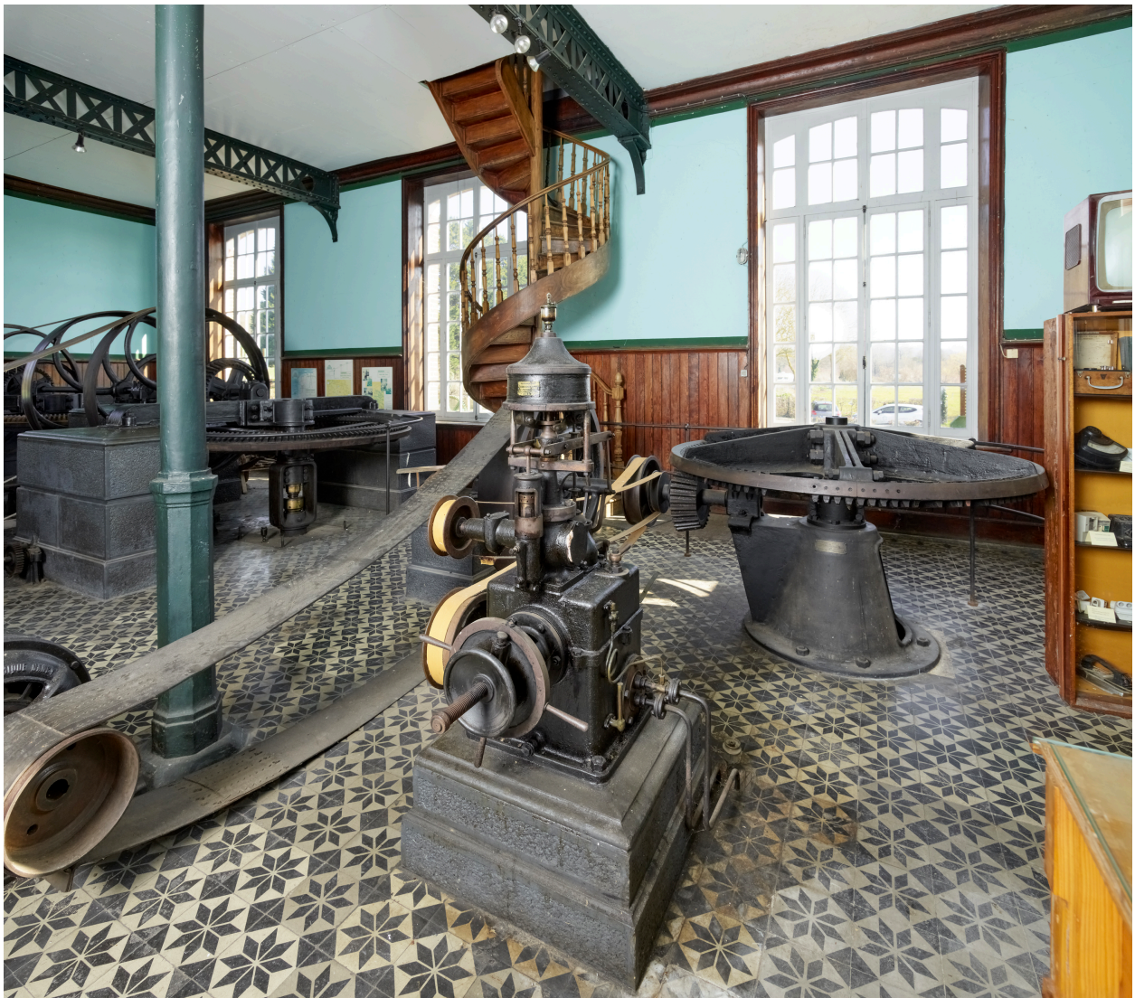
Intérieur, la troisième turbine de la centrale.
