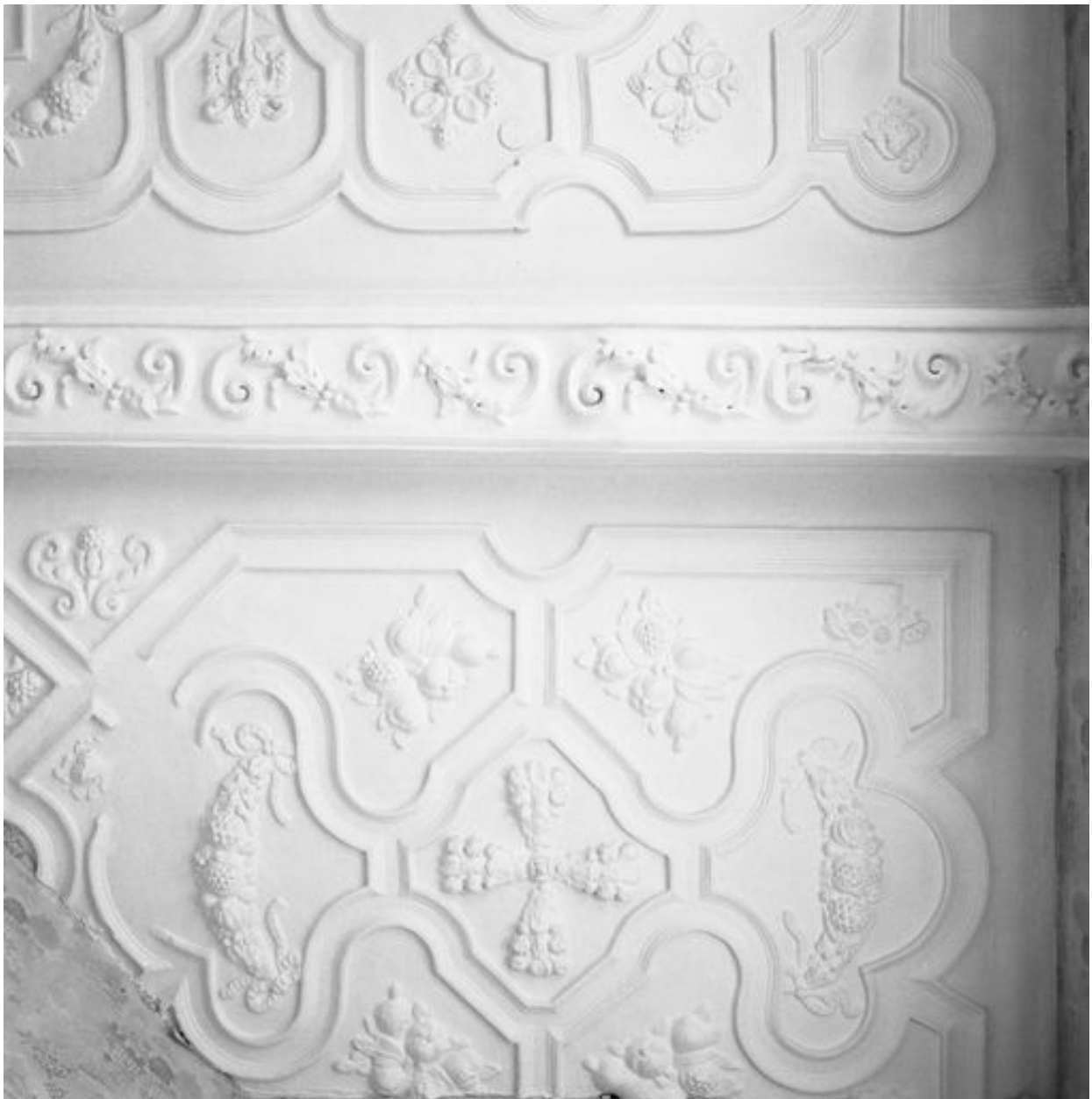
Vue partielle du plafond coupé par le cloisonnement en logements (ici, n° 35 rue de la Cavalerie).
