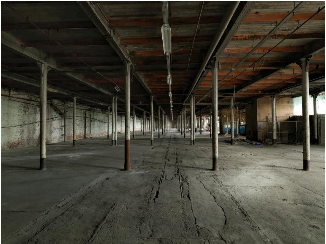
Atelier de tissage du niveau inférieur, vue intérieur longitudinale.
